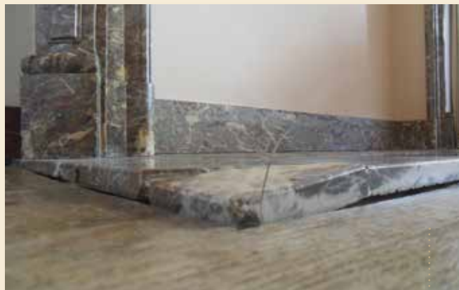
> MARMEREN HAARDVLOER. DE OMRINGENDE HOUTEN VLOER IS VERLAAGD WAARDOOR HET HOOGTENIVEAU VAN HOUT EN MARMER NIET MEER OVEREENKOMT. DIT MAAKT HET MARMER KWETSBAAR. DE HOEK VAN HET MARMER IS AL GEBROKEN. FOTO A. HEES.
